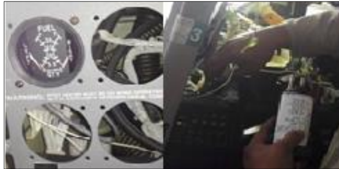
Figura 25 Colocación de FUEL QUANTITY.
