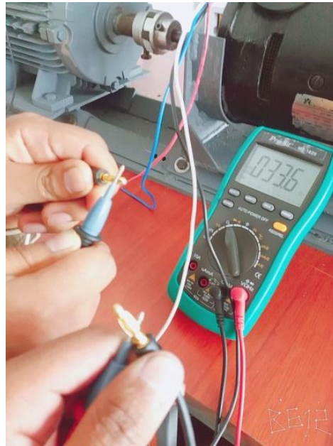
Figura 29 Medición de la resistencia
