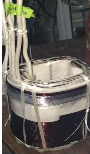
Figura 19 Aislamiento del bobinado secundario
