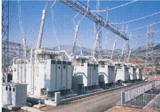
Figura 15 Autotransformador de una central eléctrica
