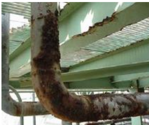
Figura 38 Efectos de la corrosión
