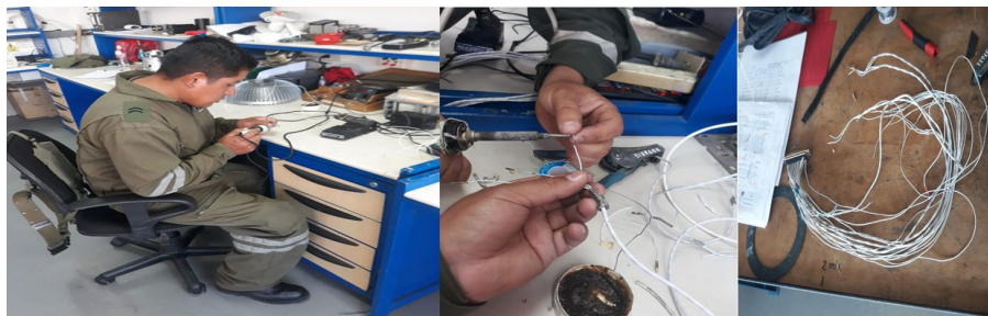
Figura 32. Arnés de cables con conectores 4001,4002 y 40006.
