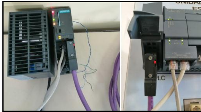
Figura 24 Cableado de la red Profibus DP en estado ON.
