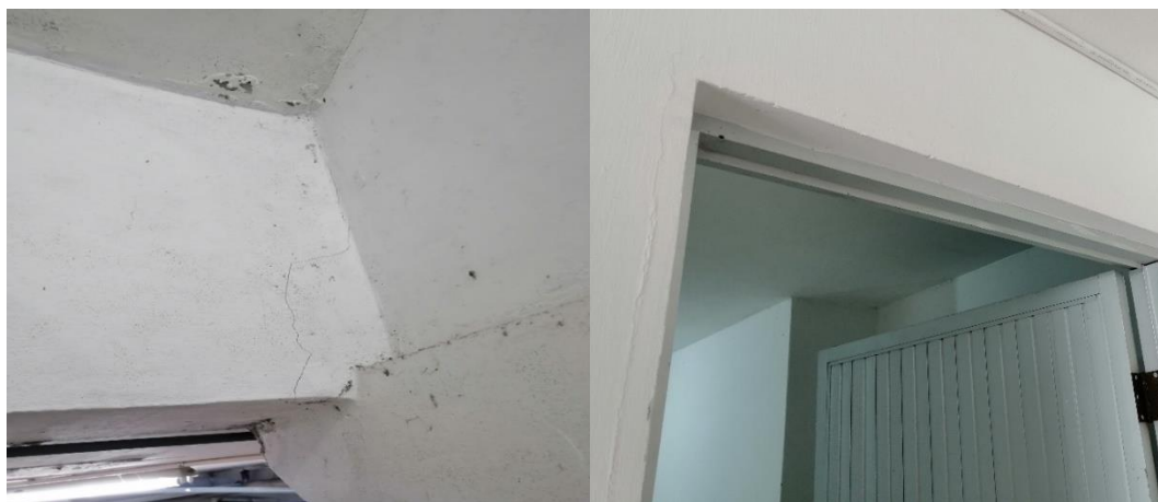
Fisuras en viga
