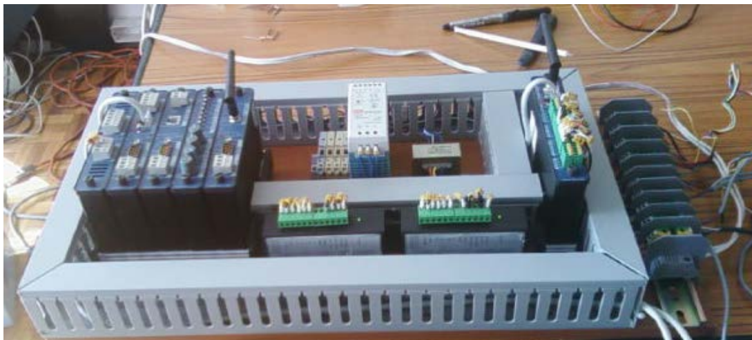
Figura 4.30. Tablero de control vista (2)
