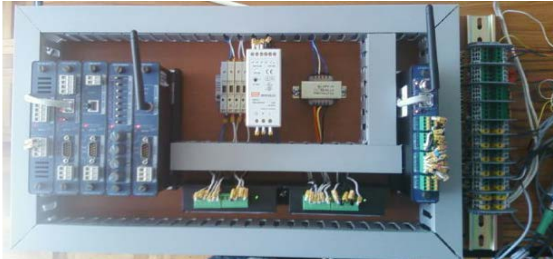
Figura 4.29. Tablero de control vista (1)
