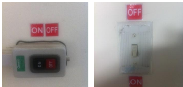
Figura 40 Identificación de interruptores
