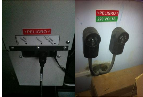
Figura 39 Identificación de voltaje 220
