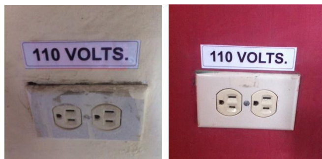
Figura 38 Identificación de voltaje 110
