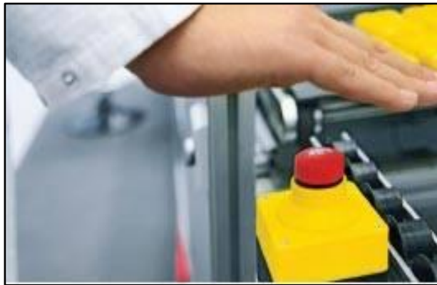
Figura 7 Dispositivo de parada de emergencia Fuente: (R.D.1215/97, 1997)
