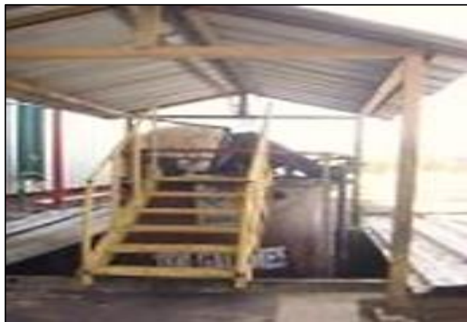
Figura 12 Tanque de almacenamiento
