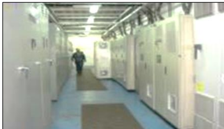
Figura 11 Cámara Eléctrica del Tren 1
