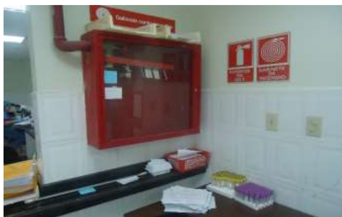
Figura 14. Gabinete contra incendios del subsuelo
