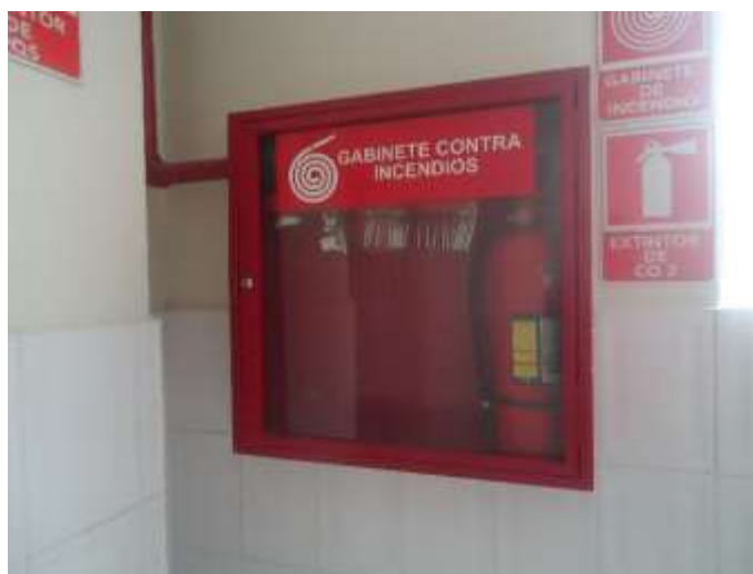
Figura 17. Gabinete contra incendios de la planta 1
