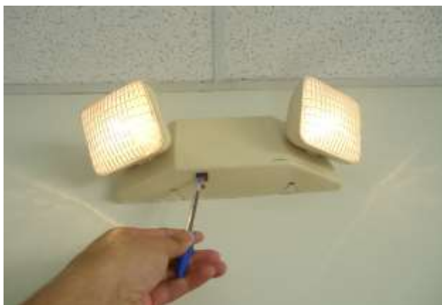
Figura 19. Luz de emergencia en buen estado
