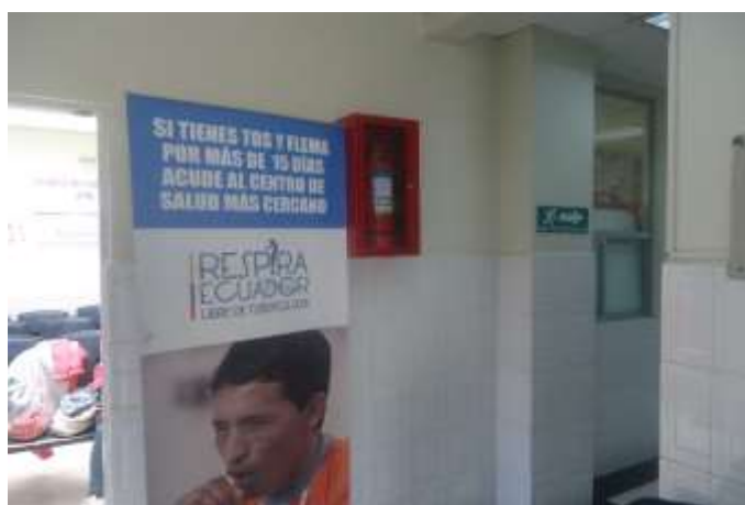
Figura 16. Extintor de la planta baja
