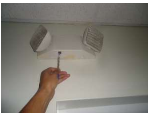
Figura 21. Luz de emergencia en mal estado
