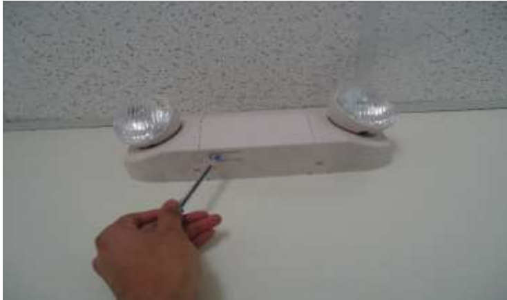
Figura 24. Luz de emergencia con carga, pero defectuosa
