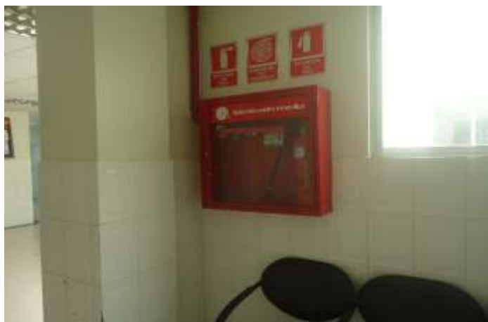
Figura 18. Gabinete contra incendios de la planta 2
