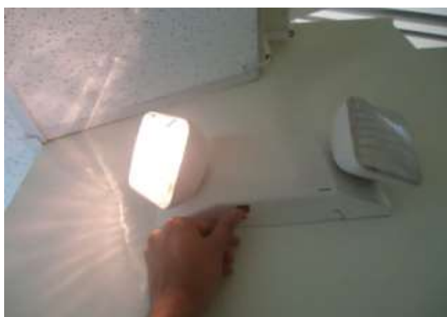
Figura 20. Luz de emergencia en estado parcial
