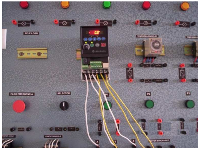
Figura 6.9 Montaje del variador PowerFlex4
