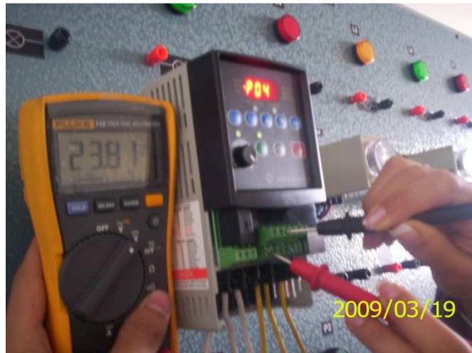
Figura 6.13 Verificación de voltaje en el Bloque de control
