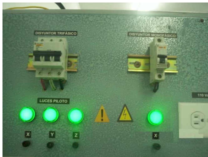
Figura 6.16 Disyuntores en posición "ON"
