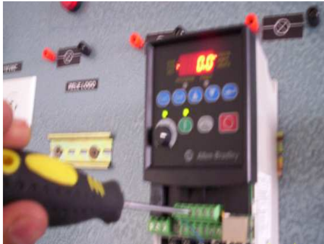
Figura 6.21 Manipulación en el bloque de control
