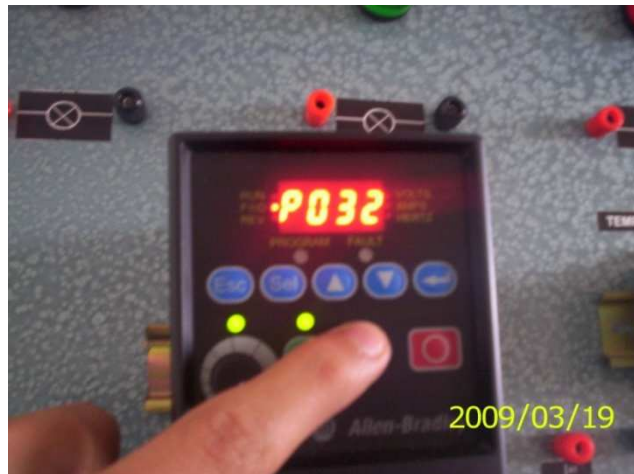
Figura 6.17 Edición de parámetros que dependen de la placa del motor
