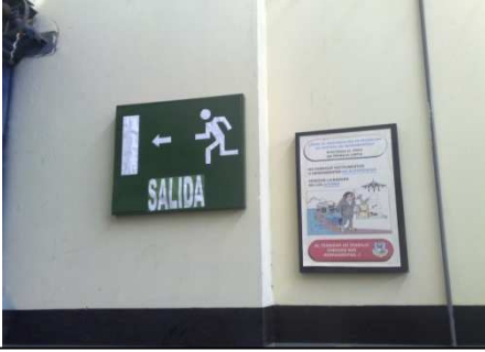
SEÑALIZACIÓN DE SALIDA DE SALIDA DE EMERGENCIA.
