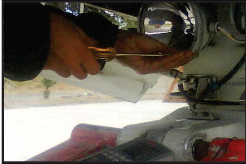
Figura 3.5 Conexión de Cables Eléctricos
