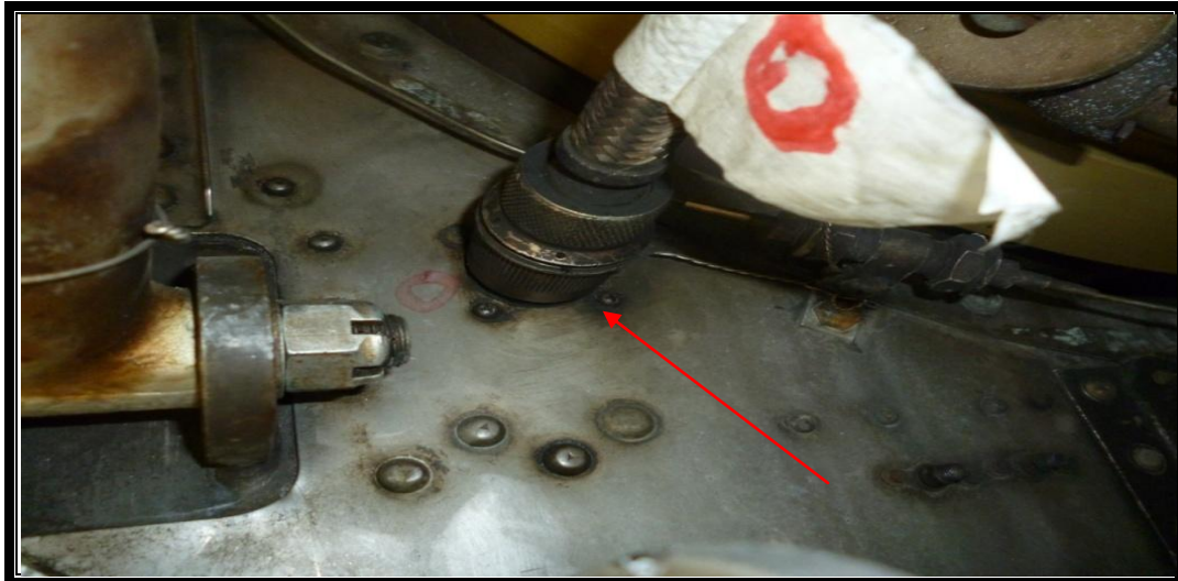
Figura 3.26: Conexión Turbine Temperature eléctrica Receptacle Elaborado por: Valeria Alulima
