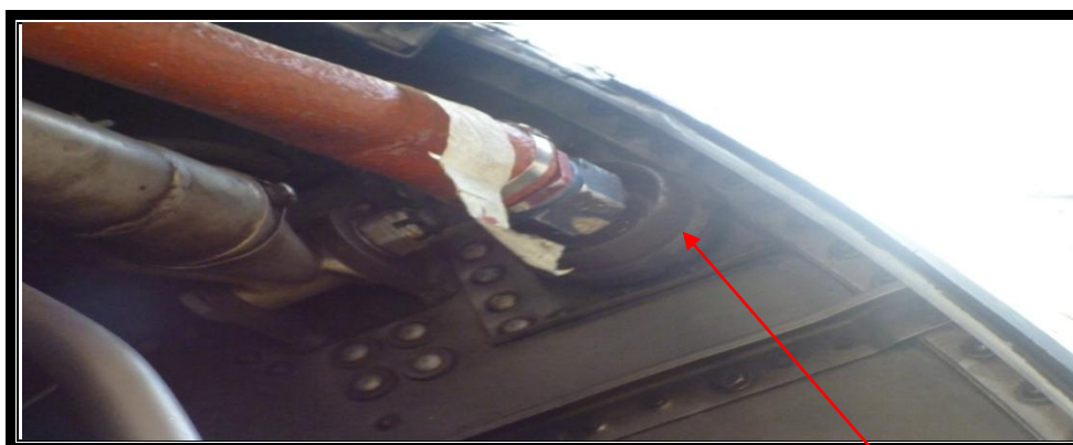
Figura 3.35: Conexión Water/Methanol Supply Line
