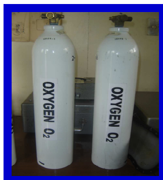
Figura.- Tanques de almacenamiento de O_2
