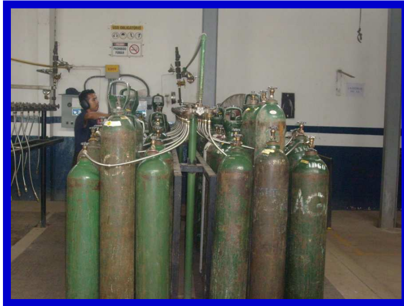
Figura 2.9.- Manejo y almacenamiento del oxígeno gaseoso
