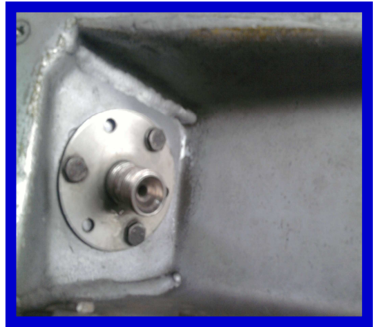
Fig. 4 Toma del avión para Oxígeno Gaseoso
