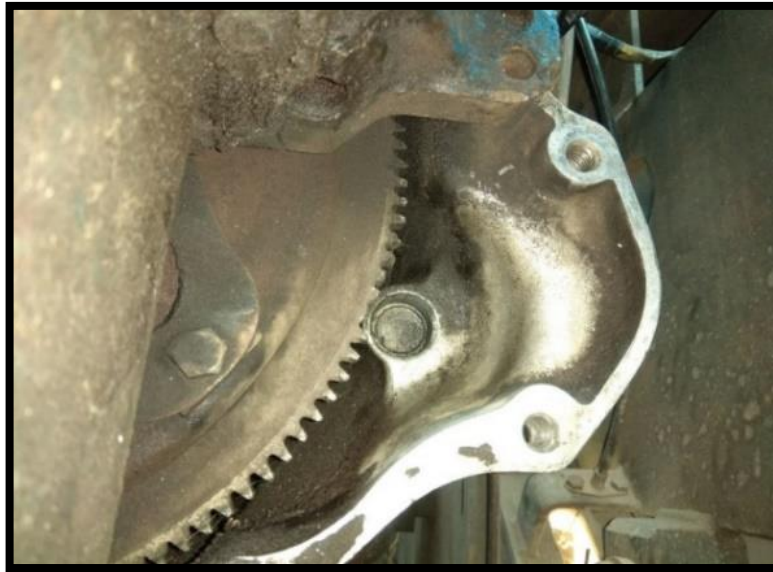
Figura 57 Volante de Inercia en mal estado Fuente Propia
