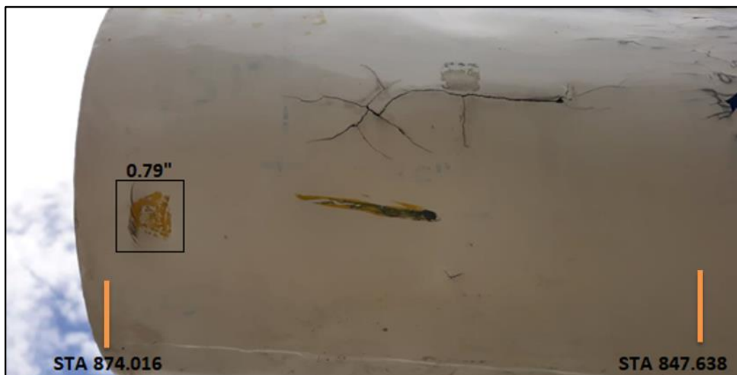
Figura 86. Hundimiento # 9 de la inspección.
