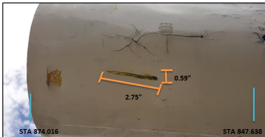
Figura 84. Hundimiento # 8 de la inspección.
