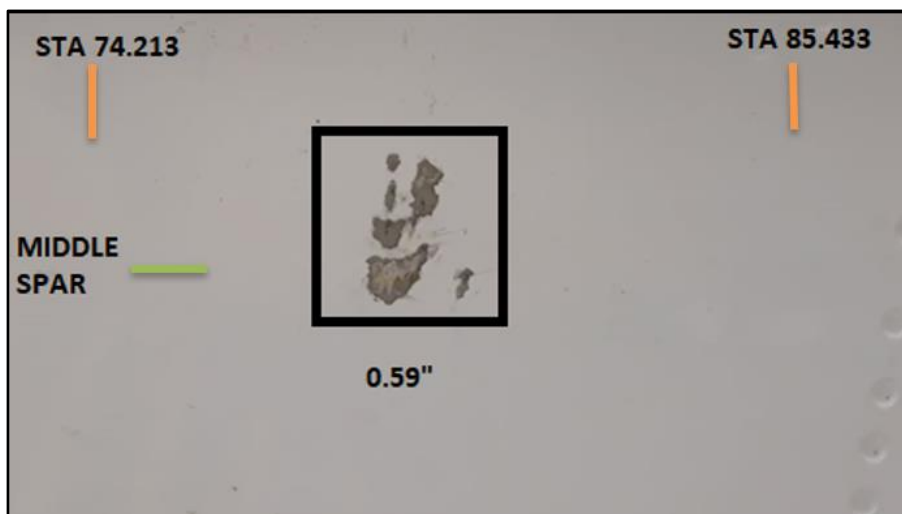
Figura 56. Rajadura # 2 de la inspección visual.
