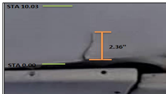
Figura 68. Rajadura # 8 de la inspección visual.
