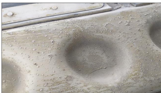
Figura 40. Presencia de corrosión
