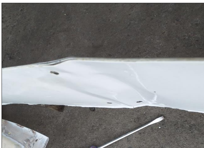
Figura 39. Daño en la piel de las cubiertas
