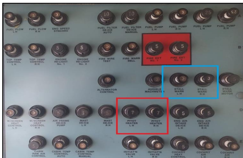
Figura 21. Circuitos de stall warning y pitot aislados
