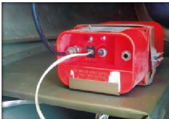
Figura 43 Verificación de los terminales y cableado del ELT
