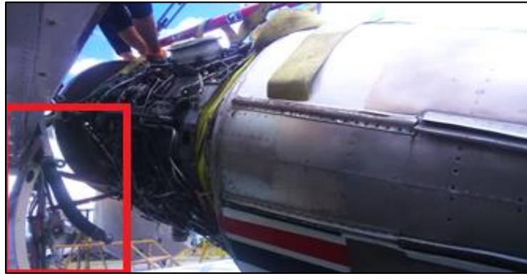
Figura 35 Cañería de alimentación de combustible
