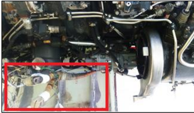
Figura 34 Cables del generador
