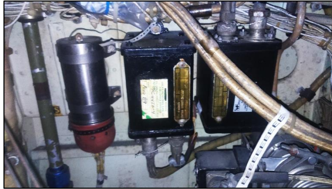
Figura 54 Cajas de alta tensión
