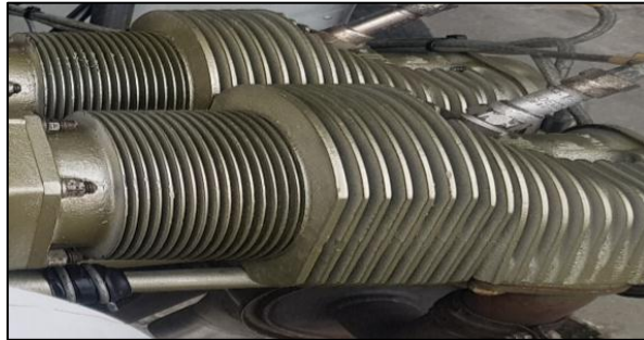
Figura 23.- Aletas de refrigeración de los cilindros derechos (2 y 4)
