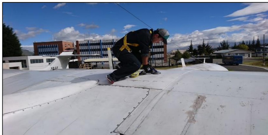
Figura 51 Instalación del equipo de seguridad.
