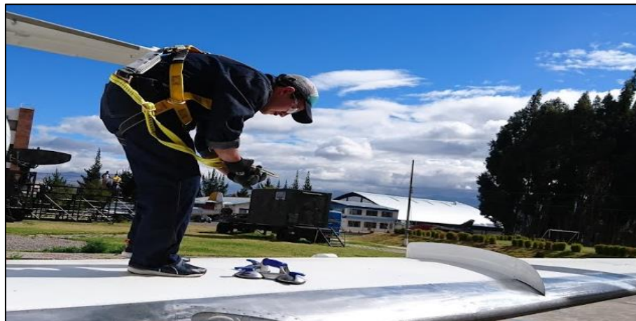
Figura 38 Implementación del equipo de protección.
