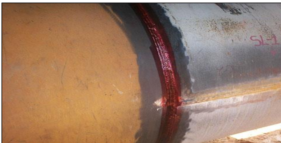
Figura 40 Aplicación del líquido penetrante.
