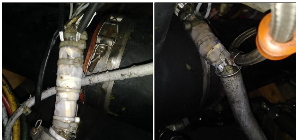
Figura 50 Malas prácticas de mantenimiento
