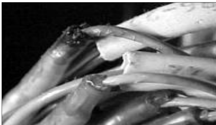
Figura 13 Daños por agentes químicos
