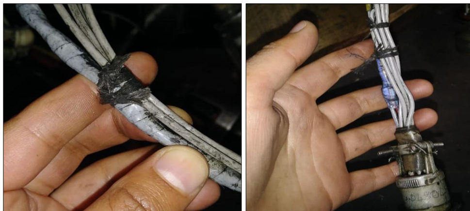
Figura 53 Deterioro de los amarres del arnés
