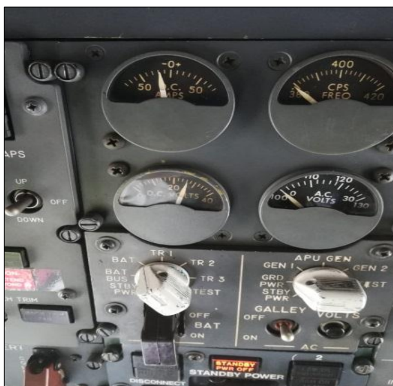
Figura 68 Switch de la batería en ON
