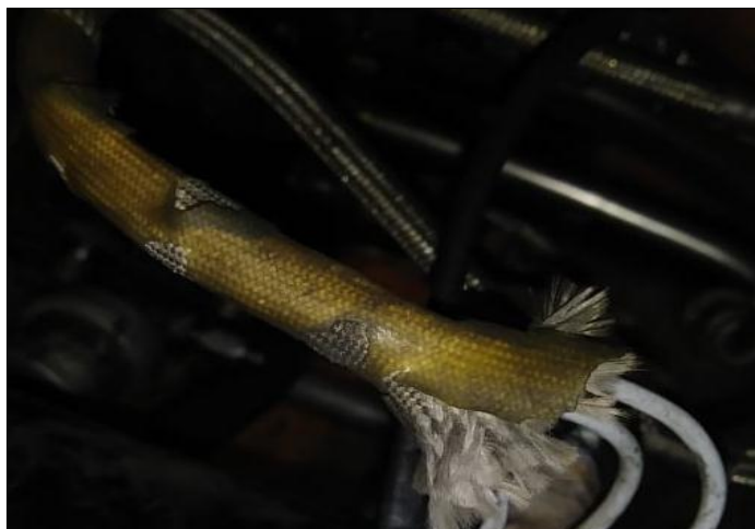
Figura 51 Deterioro de la protección de EWIS
