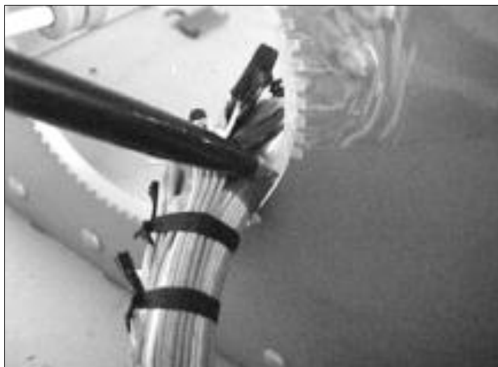
Figura 26 Cables guiados de manera incorrecta
