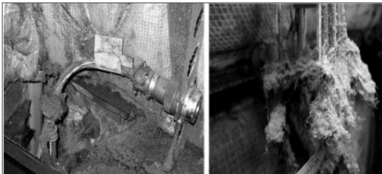
Figura 12 Daños de EWIS por polvo y pelusa
