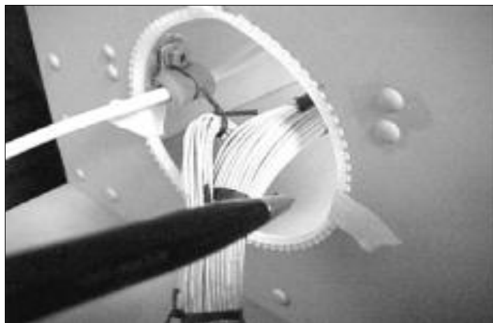
Figura 27 Manera correcta de guiar un cable
