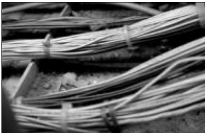
Figura 16 Instalación de EWIS
