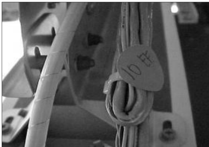
Figura 14 Daños de EWIS por calor
