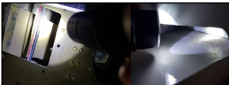
Figura 57 Inspección visual a los soportes
