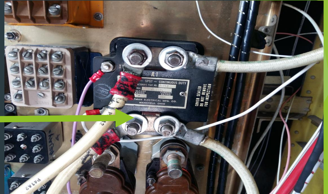
RELAY DE CONEXIÓN PARA ENERGIZAR LA AERONAVE, BARRA DE ACCESORIOS
