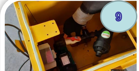
Abrir la válvula de paso
