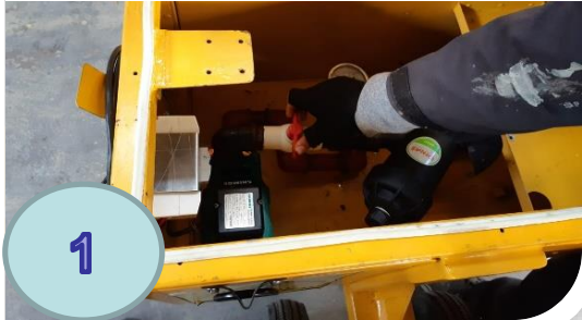
Cerrar la válvula de paso
