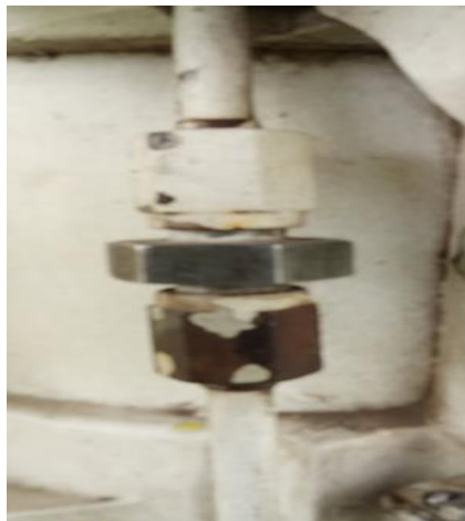
Figura 23. Fitting con presencia de corrosión.
