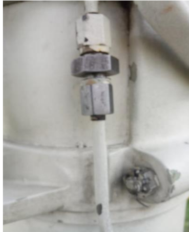
Figura 24. Fitting libre de corrosión.
