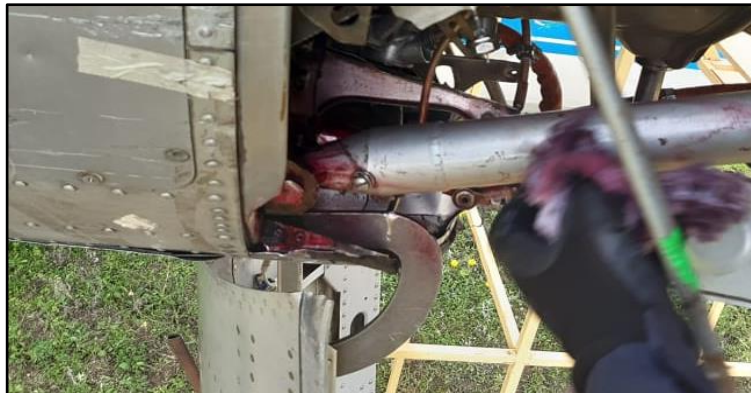
Figura 88. Tinte penetrante al montante inferior izquierdo.
