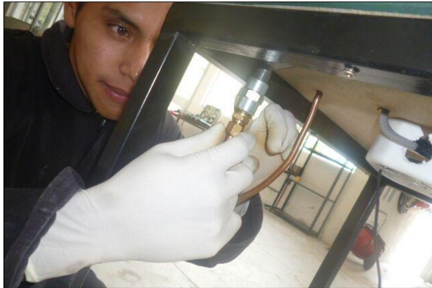
Figura 44 Instalación de la línea rígida a la toma de aire de descarga
