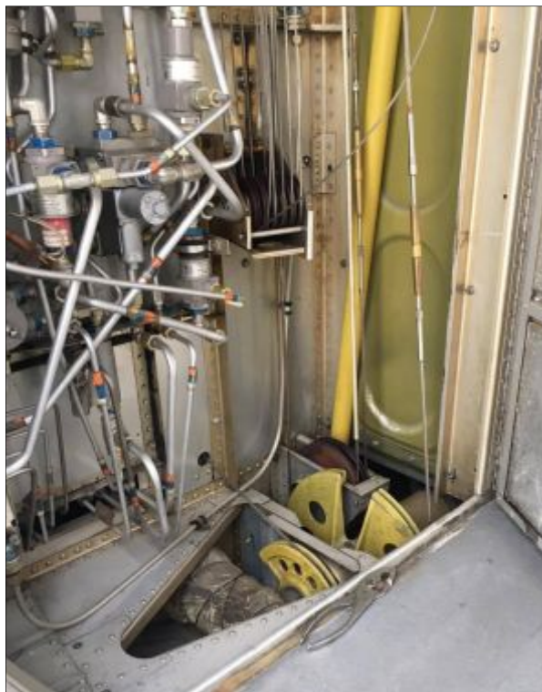
Figura 44 Cables de la mampara del compartimento de tripulación.
