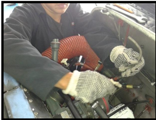
Figura 172 Ventilación de la bomba de vacío.
