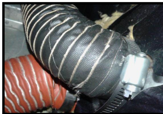
Figura 166 Mangueras de ventilación.
