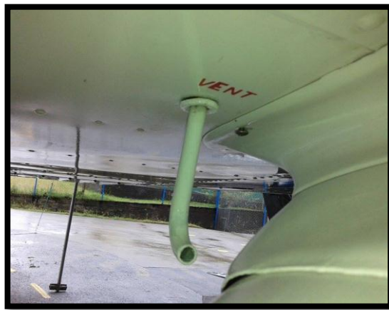
Figura 156 Ventilación de los tanques.
