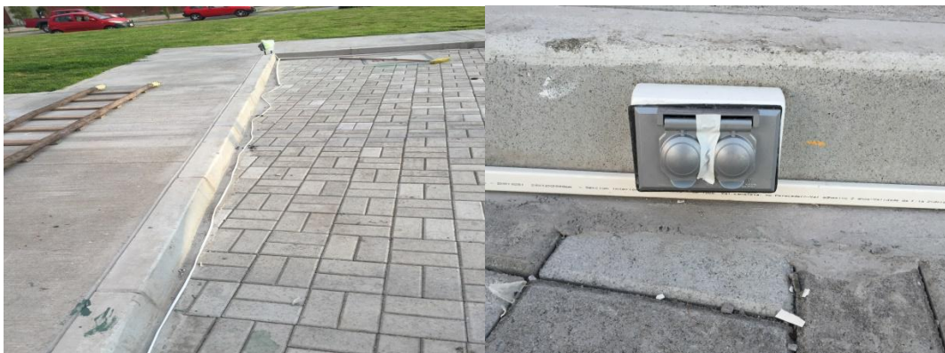
Figura 41 Ruteado del cableado eléctrico de los reflectores
