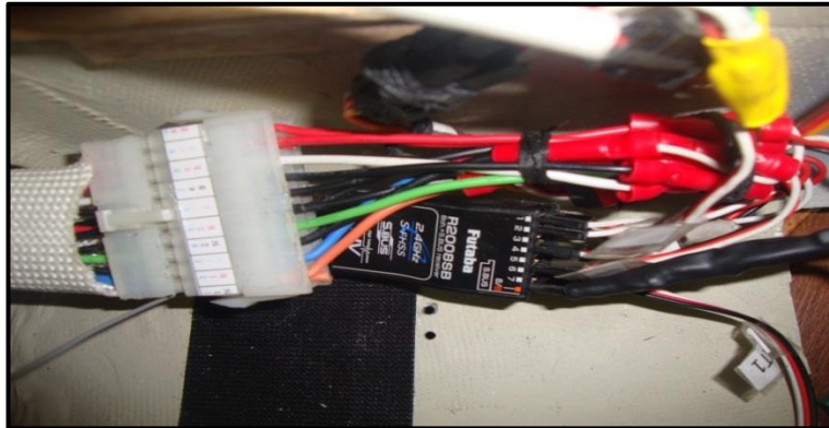
Figura 72 Circuito receptor instalado.
