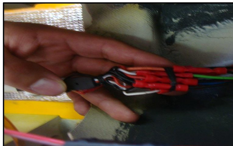
Figura 40 Amarre de seguridad de las sueldas frías.
