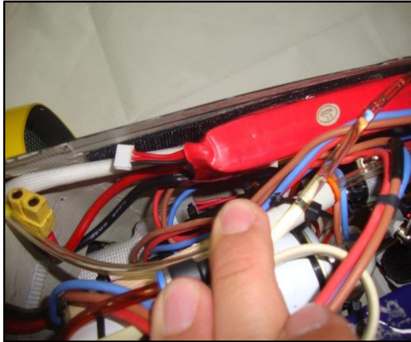
Figura 76 Bateria instalada en el fuselaje.
