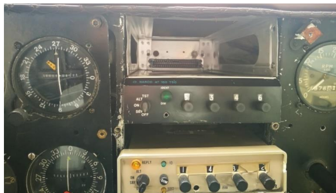
Figura 32. Identificación de daños
