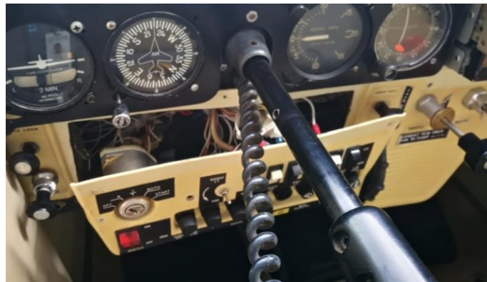
Figura 39. Remoción del panel de fusibles e interruptores.
