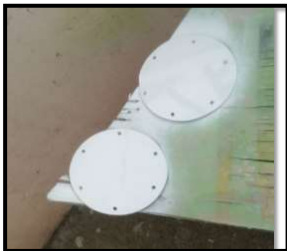
Figura 38. Tapas de inspección pintadas
