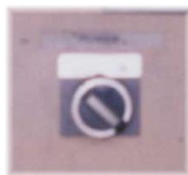
Fig. 3.4. Selector de encendido / apagado (dañado)
