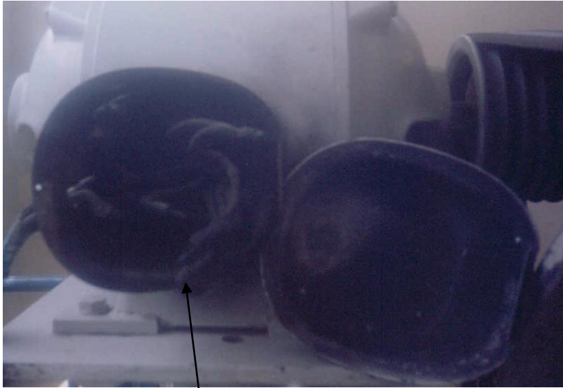
Fotografía No. 3.12 Cables fundidos en la caja de bornes del compresor.
