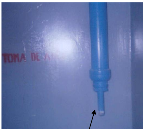
Fotografía 3.22 Drenaje sin válvula distribuidora.
