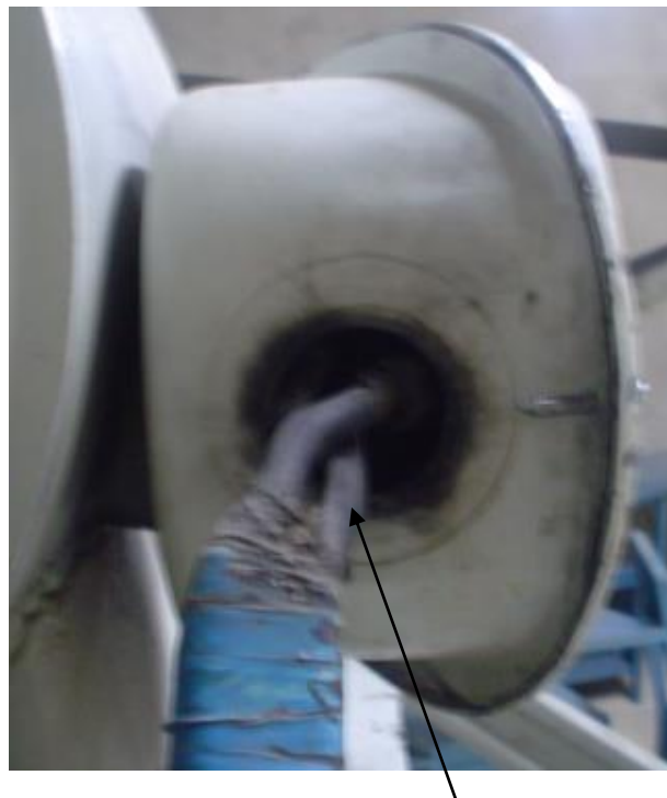
Fotografía No. 3.5 Conexiones quemadas.
