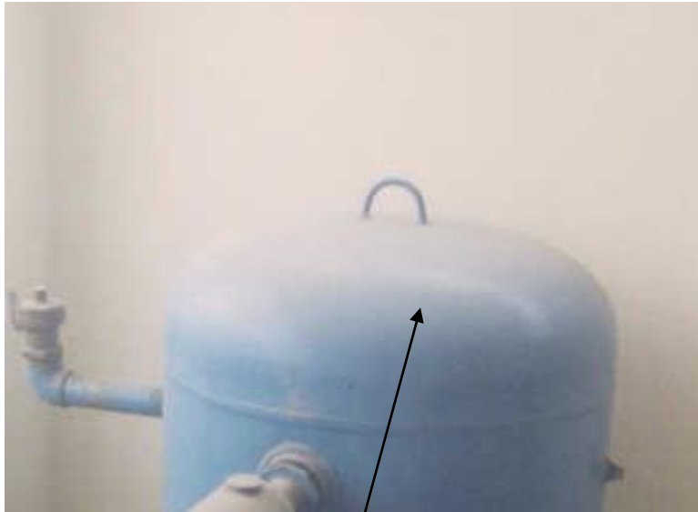
Fotografía No. 3.15 Acumulador de aire comprimido.
