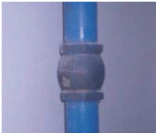
Fotografía No. 1.8 Válvula check
