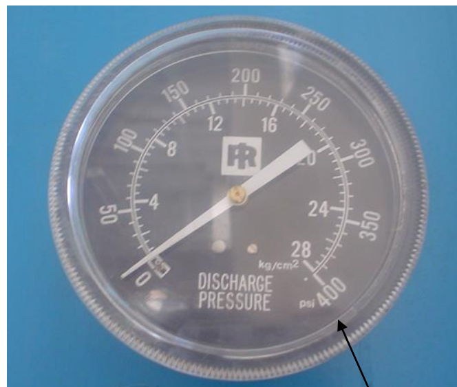
Fotografía No. 3.29 Manómetro del acumulador
