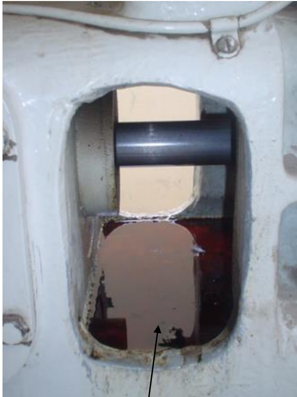
Fotografía No. 3.13 Recolector de aceite del eje sucio.
