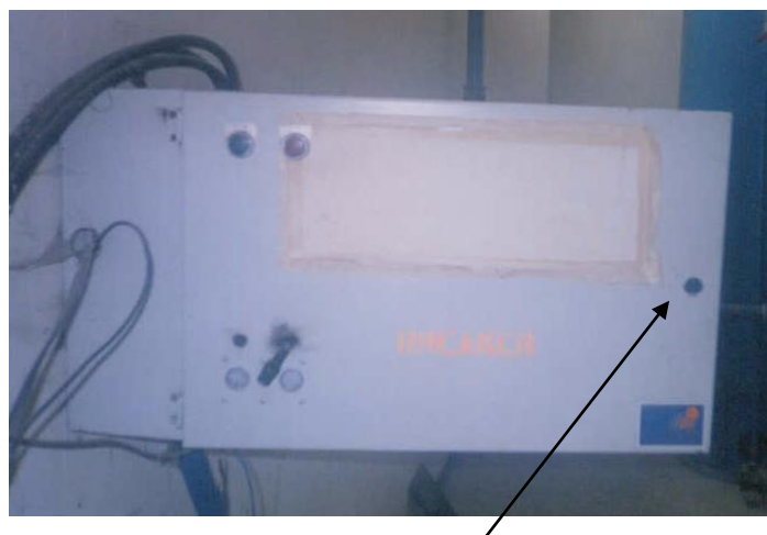
Fotografía No. 3.4 Tablero sin seguridades.
