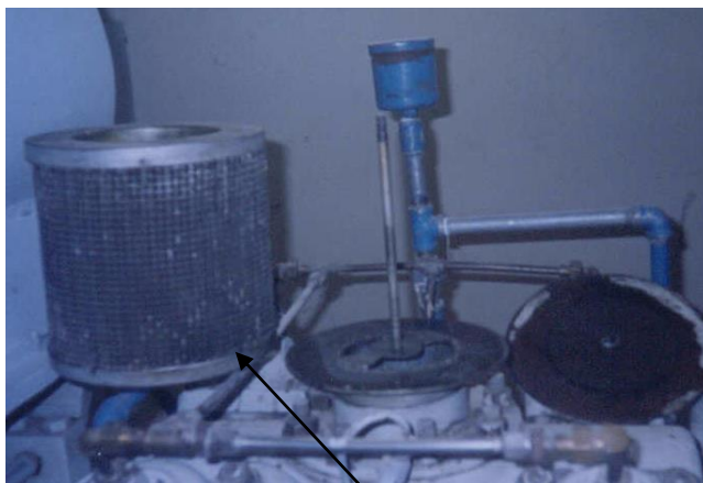
Fotografía No. 3.23 Filtro Metálico desarmado.
