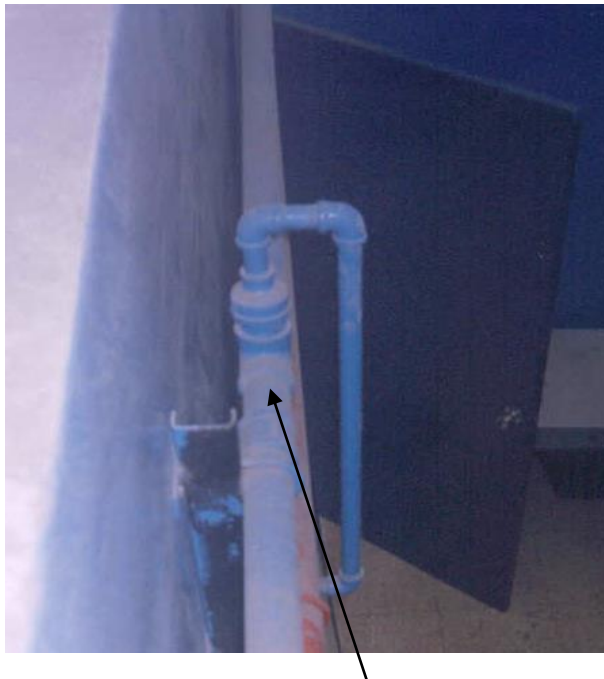
Fotografía No. 3.21 Tubería empolvada.
