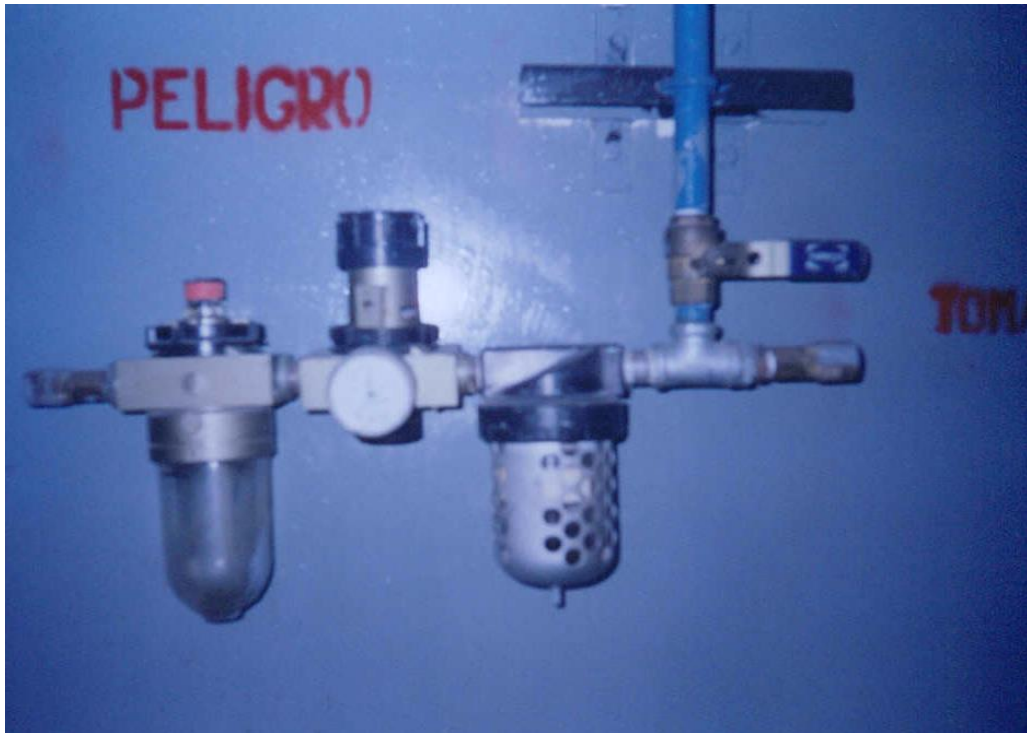
Fotografía No. 1.5 Filtros de la toma de aire.
