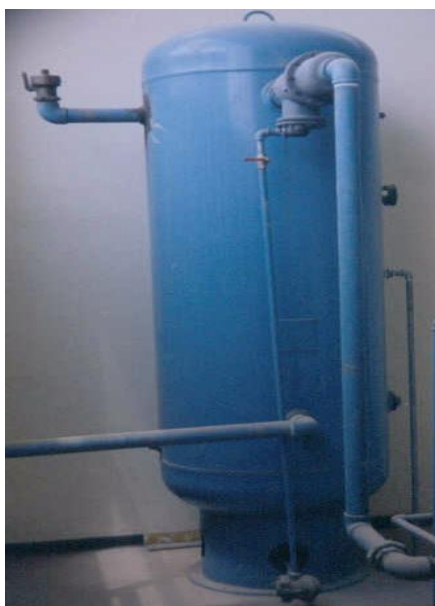
Fotografía No. 1.2 Depósito de aire comprimido.
