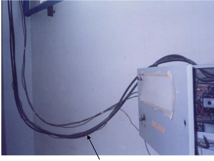
Fotografía No. 3.1 Cables se encuentran sueltos.
