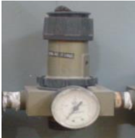
Fotografía No. 1.11 Manómetro de la toma de aire
