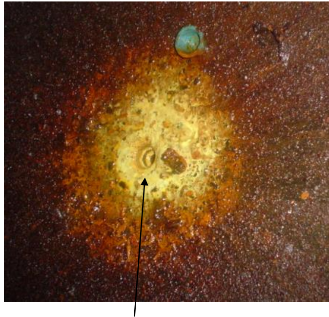
Fotografía No. 3.17 Parte inferior interna del acumulador.
