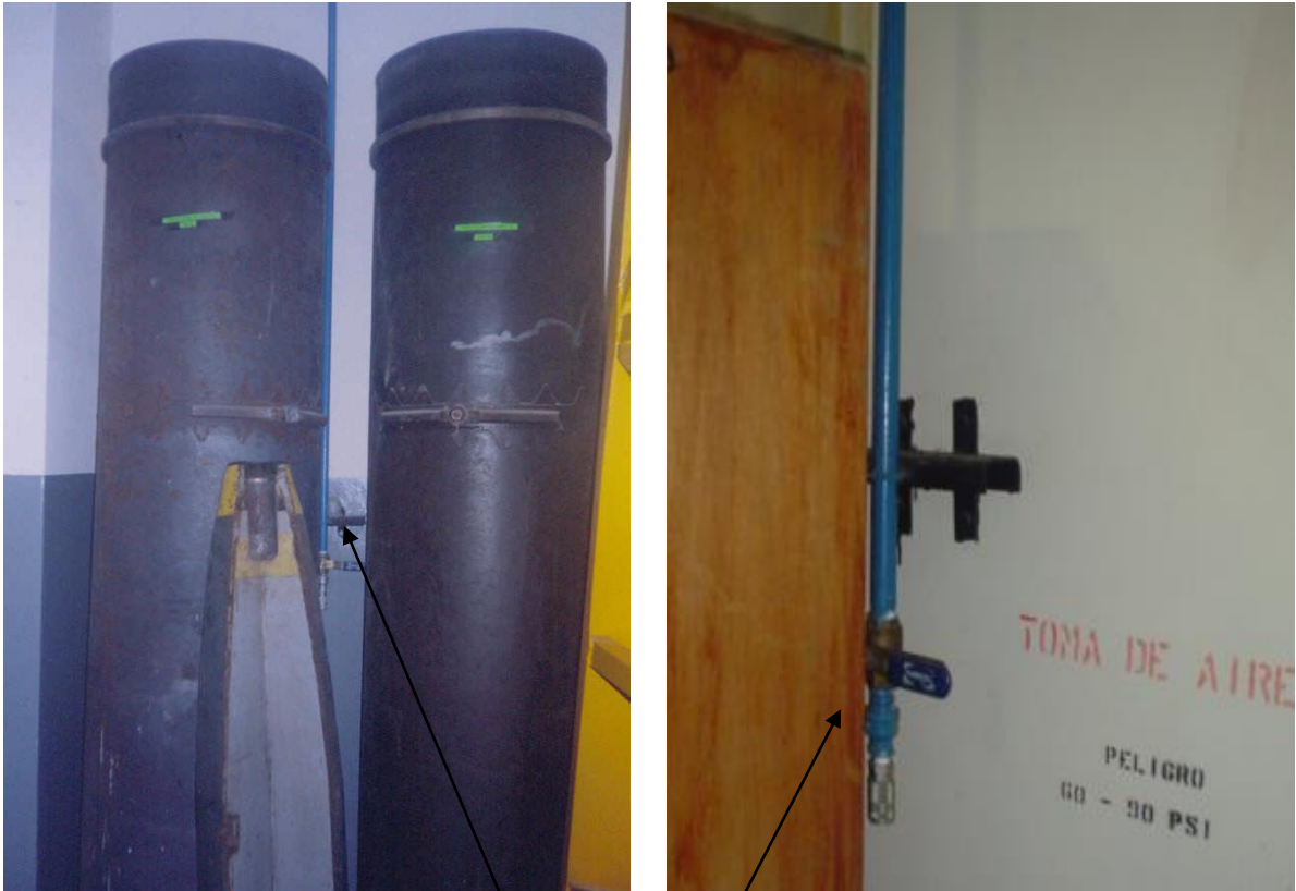
Fotografía No. 3.33 Toma de aire obstruida.
