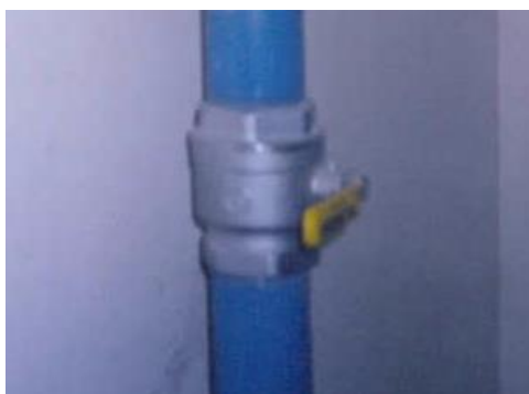
Fotografía No. 1.9 Válvula distribuidora.
