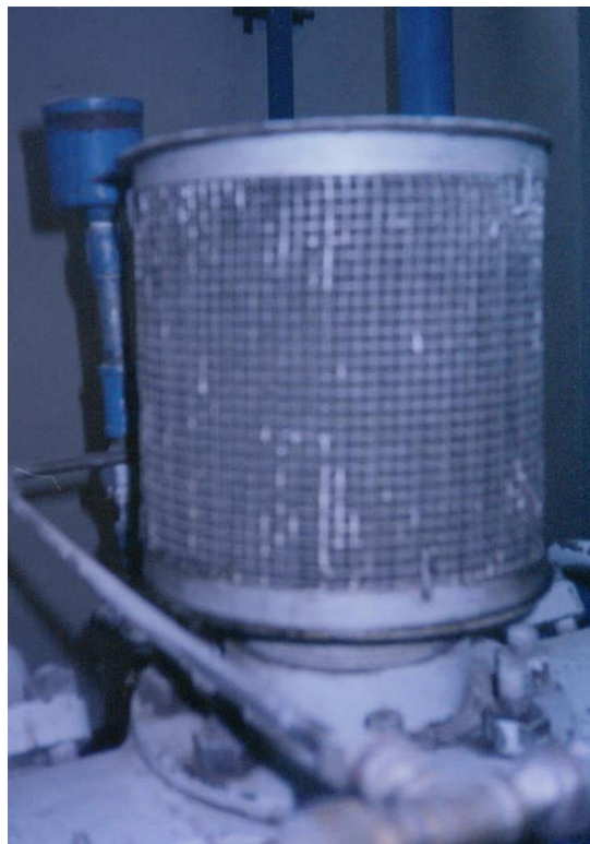
Fotografía No. 1.4 Filtro de aire del compresor.
