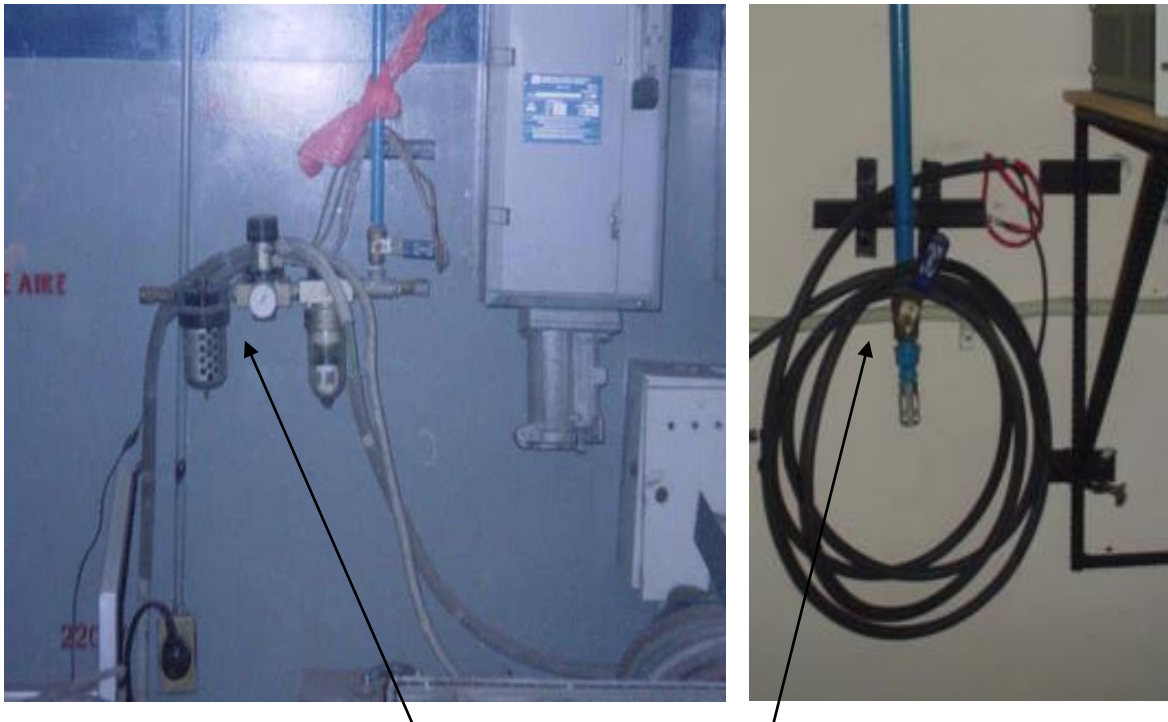
Fotografía No. 3.26 Filtros y tomas con cables colgados en su estructura.
