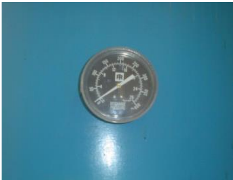
Fotografía No. 1.10 Manómetro del acumulador.
