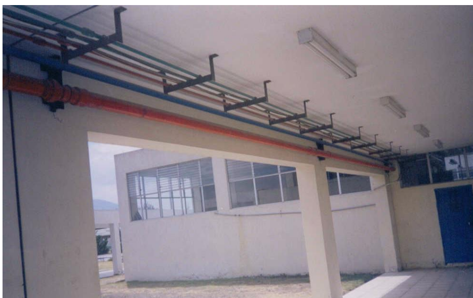
Fotografía No. 1.3 Red de distribución neumática.
