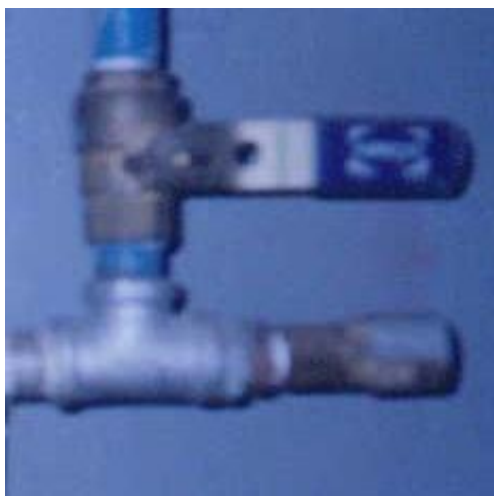
Fotografía No. 1.12 Toma de aire.
