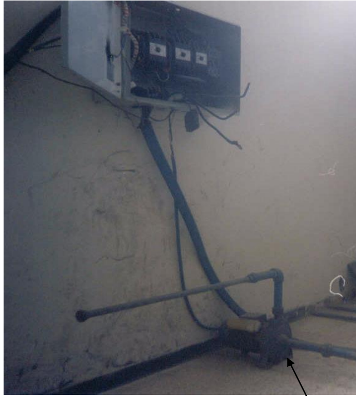
Fotografía No. 3.9 Bomba de agua bajo el tablero de conexiones.
