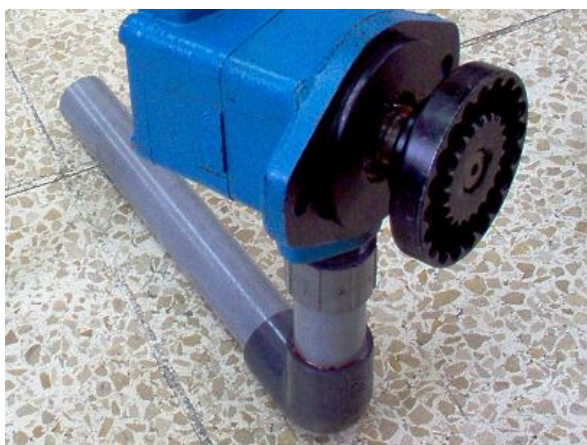
Figura 2.7: Tubería galvanizada de transporte del líquido hidráulico
