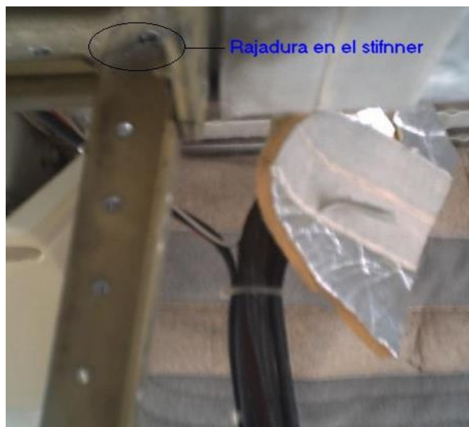
Figura 2.2 Rajadura del stiffener
