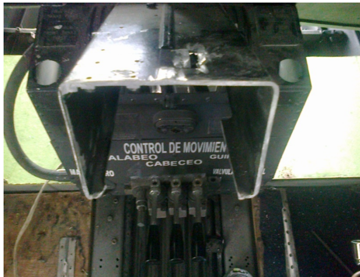
Figura 3.31 Estante donde se instalaron los mandos de control.
