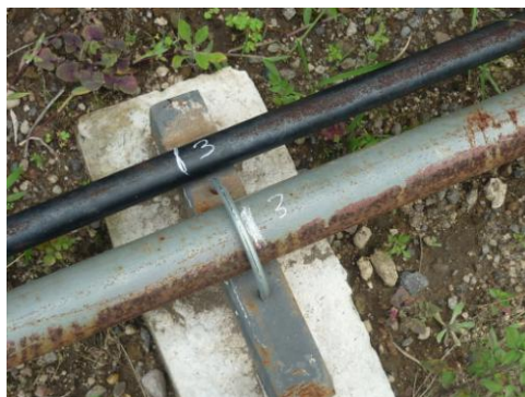
Imagen 7.17: Tuberías de cieno y vapor sobre su base.
