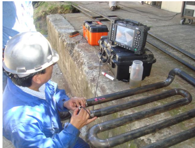
Imagen 7.30: Prueba de ultrasonido en el serpentín de la fosa de rebosamiento.
