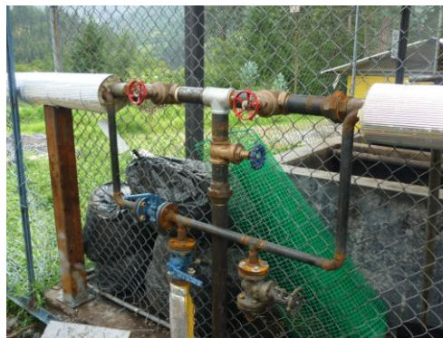
Imagen 7.53: Sistema de bombeo redistribuido.
