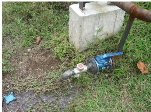
Imagen 7.50: Colocación de válvulas y trampas de vapor termodinámicas a lo largo de la línea.
