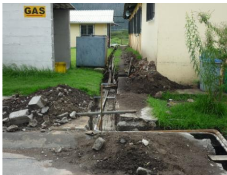
Imagen 7.10: Tubería expuesta en el sector de la imagen 7.9
