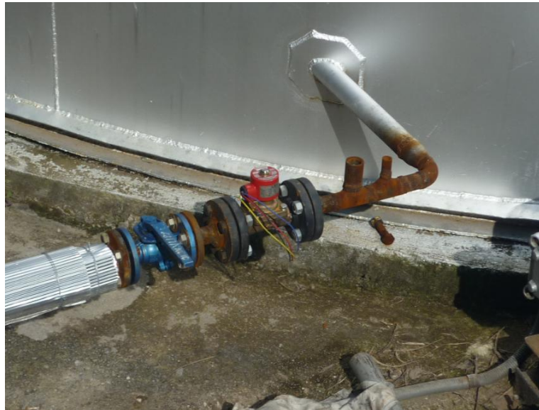
Imagen 7.55: Acometida de los serpentines a la línea de vapor mediante electroválvula.
