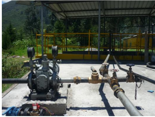
Imagen 7.48: Redistribución del sistema de bombeo..
