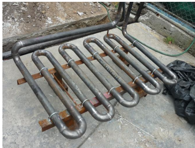
Imagen 7.31: Soportes del serpentín de la fosa de rebosamiento.
