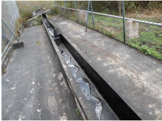
Imagen 7.21: Canal que conduce el cieno a las piscinas.
