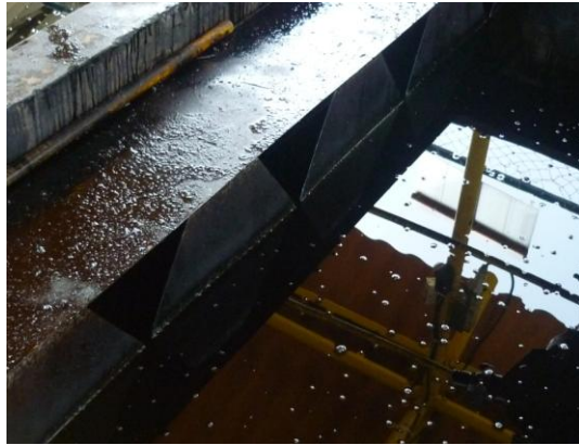
Imagen 7.22: Piscinas de decantación con los rebosaderos instalados.
