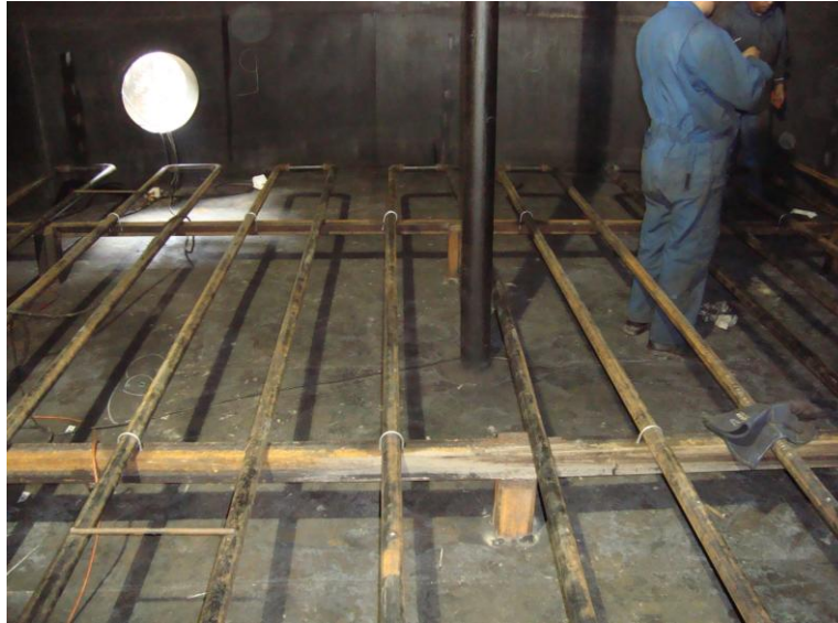
Imagen 7.32: Soportes del serpentín del tanque de almacenamiento API2.
