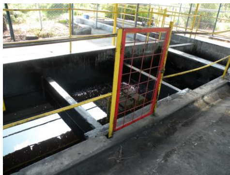
Imagen 7.20: Piscinas de decantación sin rebosaderos.
