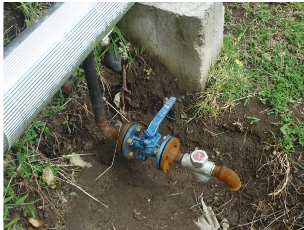
Imagen 2. Válvulas de las trampas de vapor.
