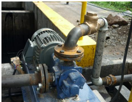
Imagen 7.57: Detalle de las líneas de succión y descarga.
