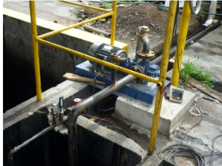
Imagen 7.56: Nueva bomba instalada, con sus líneas de succión a la fosa y descarga.
