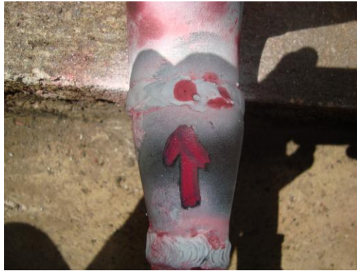
Imagen 7.42: Detección de una porosidad a la salida del serpentín del tanque API2.
