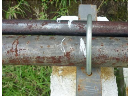
Imagen 7.18: Tuberías de cieno y vapor aseguradas a su base mediante abrazaderas tipo U.
