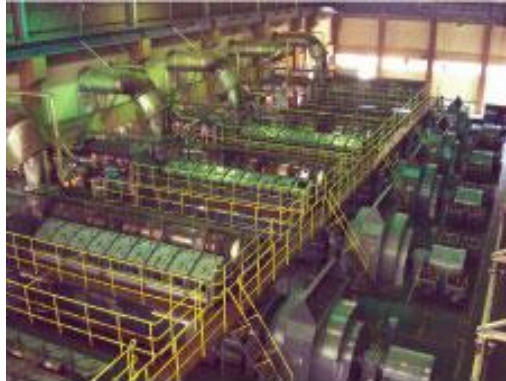
Imagen 1.2: Motores Mitsubishi – MAN, de la central Guangopolo
