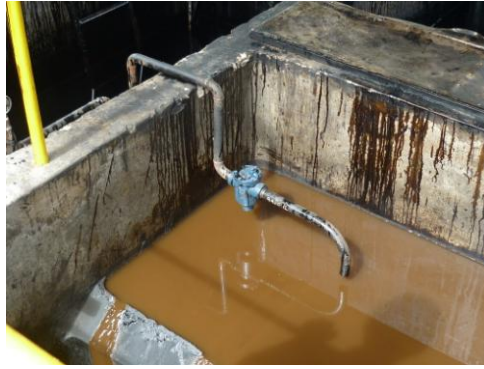
Imagen 7.51: Trampa de vapor de balde invertido al final del serpentín de la fosa de rebosamiento.
