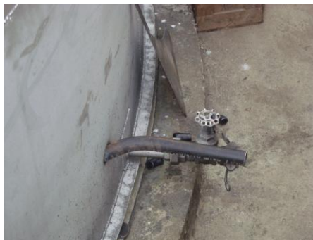
Imagen 7.39: Salida del serpentín del tanque de cieno API2.
