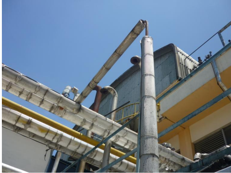
Imagen 7.54: Acometida de la línea principal de la Central.
