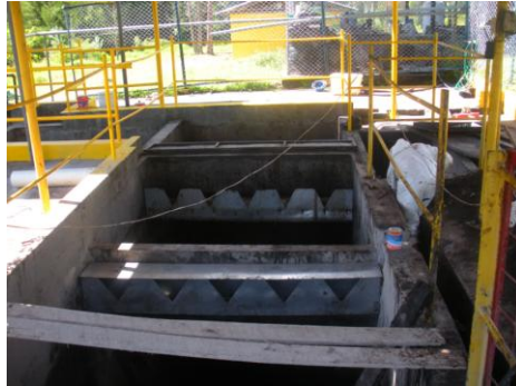
Imagen 7.24: Canal de la fosa de rebosamiento.
