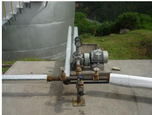
Imagen 7.49: Sistema de bombeo redistribuido.
