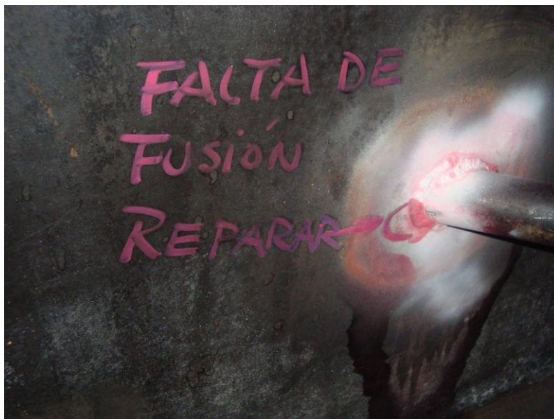
Imagen 7.41: Detección de una fuga dentro del tanque API2.
