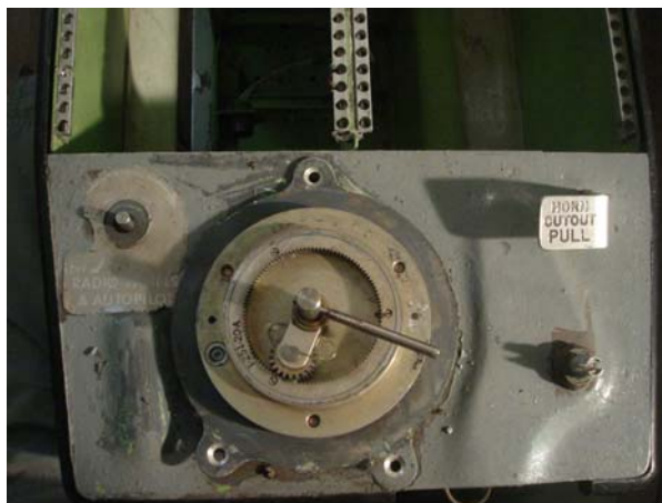
Fig. 27.- Aditamentos en mal estado.
