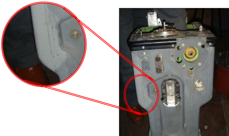
Fig. 31.- Mal estado de la pintura.
