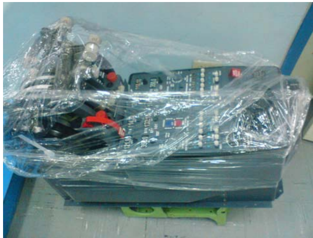
Fig. 65.- Estación de Mando y Control completamente rehabilitada.
