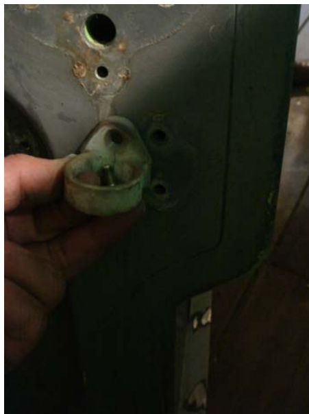
Fig. 29.- Mal estado de las piezas y corrosión.
