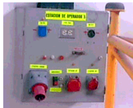
Figura 1.6 Señalización de voltajes
