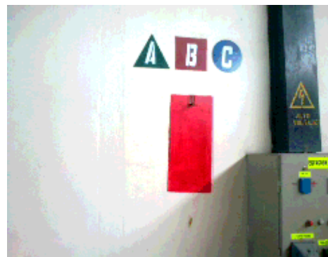
Figura 1.2 No existe extintores
