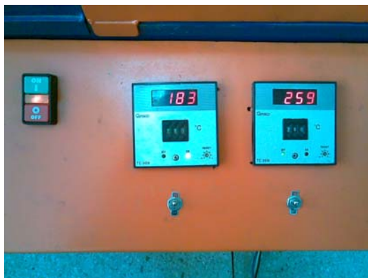
Fig. 5.13 Controladores digitales de temperatura sobre el panel metálico
