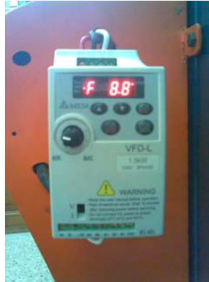
Fig. 5.17 Variador de frecuencia para controlar la velocidad de giro
