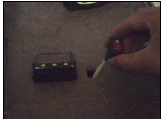
Figura 5.47.- Orificio del interruptor
