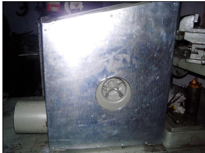
Revestimiento de la estructura del ventilador
