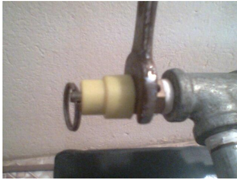
Figura 3.5 Ensamble de válvulas de seguridad
