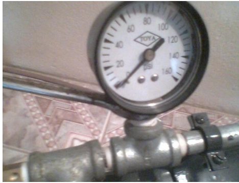
Figura 3.9 Ensamble de los manómetros.
